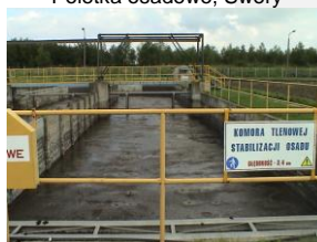
Komora stabilizacyjna , oczyszczalnia Chojnice
